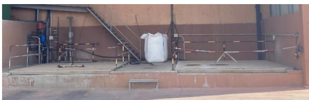
Fig. 16: dipòsits on s'aboca la matèria orgànica
