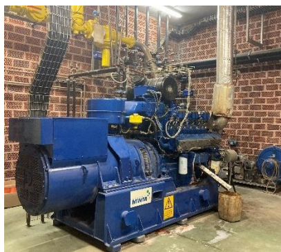
Fig. 19: motor que produeix energia elèctrica
